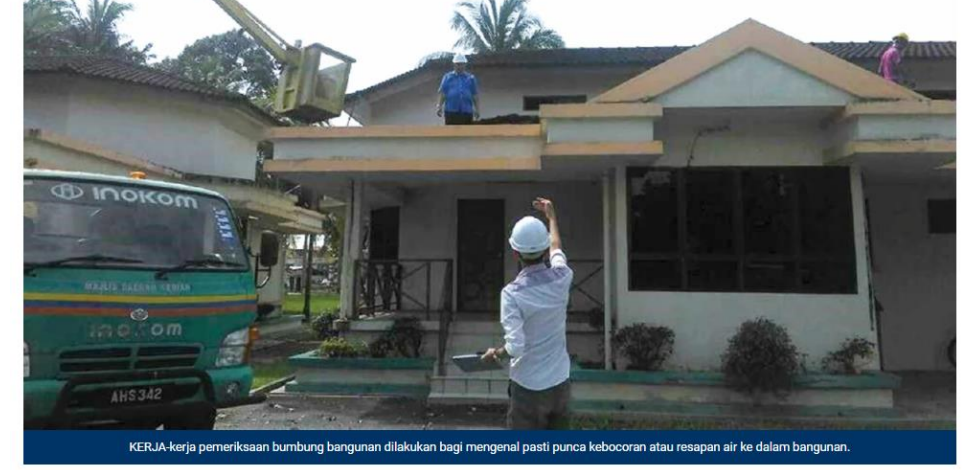
KERJA-kerja pemeriksaan bumbung bangunan dilakukan bagi mengenal pasti punca kebocoran atau resapan air ke dalam bangunan.
